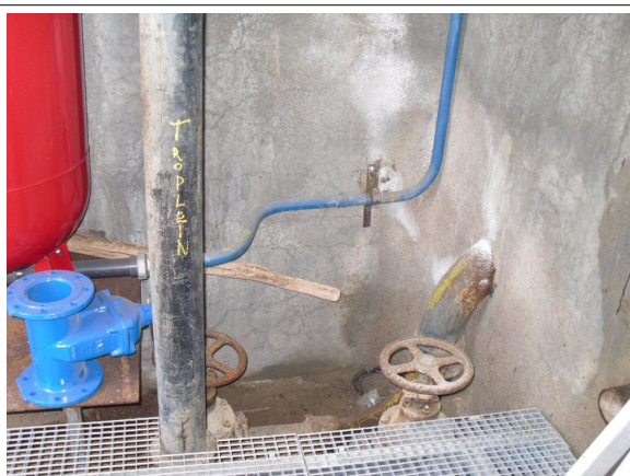
Chambre de Vanne - côté gauche
