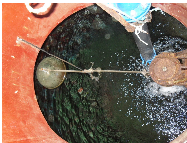
Bâche de stockage
