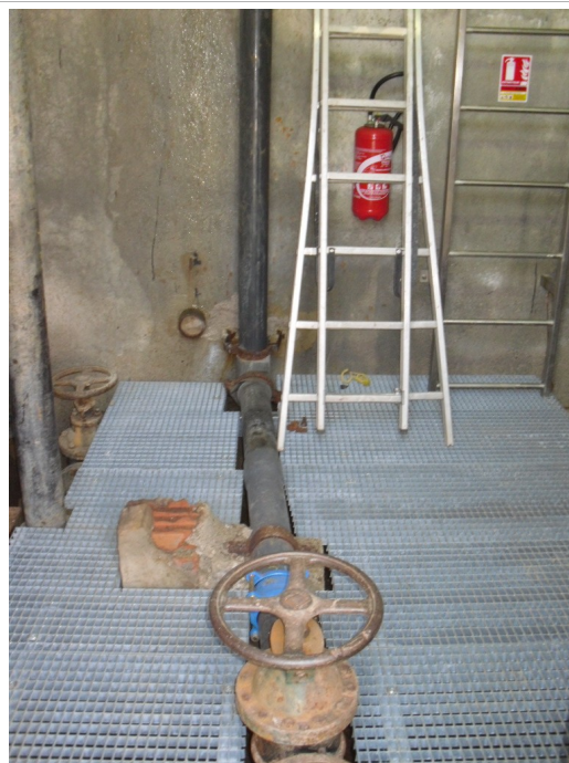
Caillebotis de sol et arrivée d'eau
