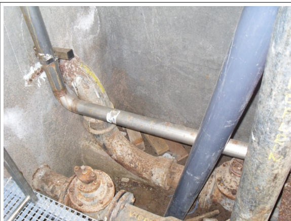
Chambre de Vanne - côté droit
