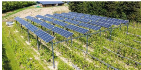
Exemples d'installation sur des vignobles (sources : Sun Argi et Citego)
